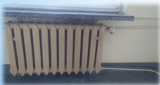
KMP/KWP z.s. w Radomiu – modernizacja sieci c.o. wraz z modernizacją systemów grzewczych, wentylacji i chłodzenia w bud. 1,3 i 4 oraz budowa instalacji solarnej c.w.u. w bud nr 4.
